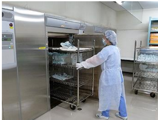
図 5 - 1 3 病院内大型オートクレーブ (札幌医大附属病院医療材料部) http://sapmed-kango.jp/nursingroom/nursingroom_27/
